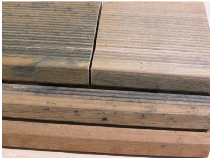
Korrosionsflecken auf der Oberfläche
